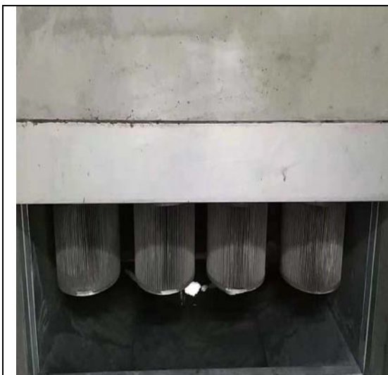
喷粉废气回收装置
