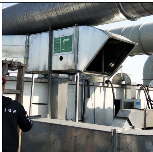
喷粉废气排气筒
