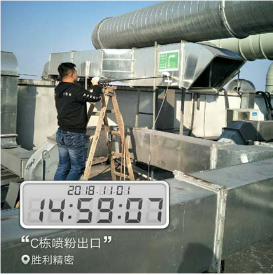
喷粉工段处理设施出口
