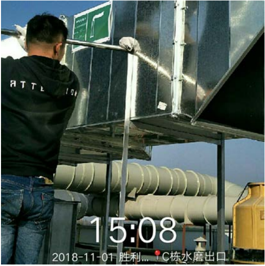
水膜除尘处理设施出口
